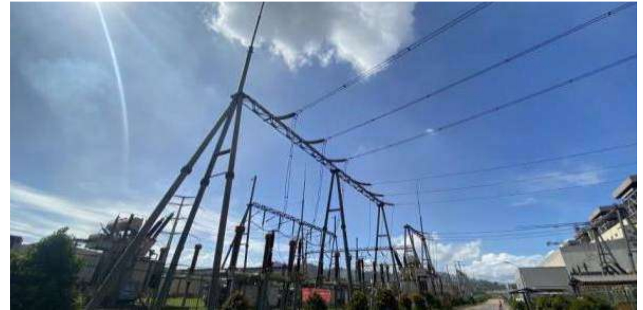
saluran transmisi tegangan menengah
