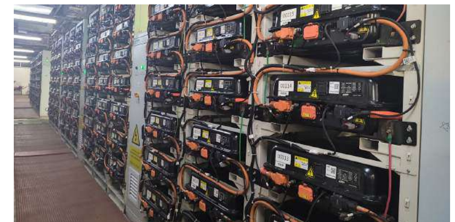
Proyek Penyimpanan Energi dengan Baterai Lithium untuk Hot Rolling Steel
