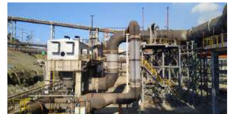
Pembangkit Listrik Tekanan Turbin Residual (TRT) PT.DSI
